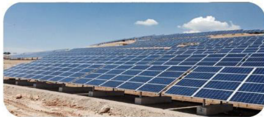
Figure 24 : Structures fixes sur longrines béton (centrale solaire URBASOLAR de Fuveau (13)) (Source : URBASOLAR)
